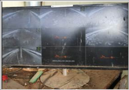
CCTV 고장 방치
